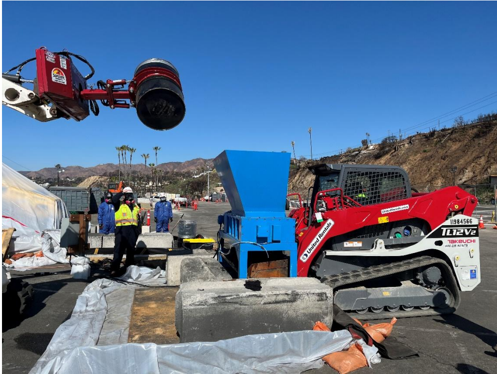
Figura 17. Ejemplo de una operación de trituración.
